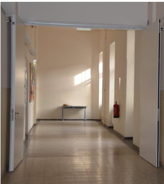
Abbildung 21: automatisch schließende Brandschutztür Foto: StRH
