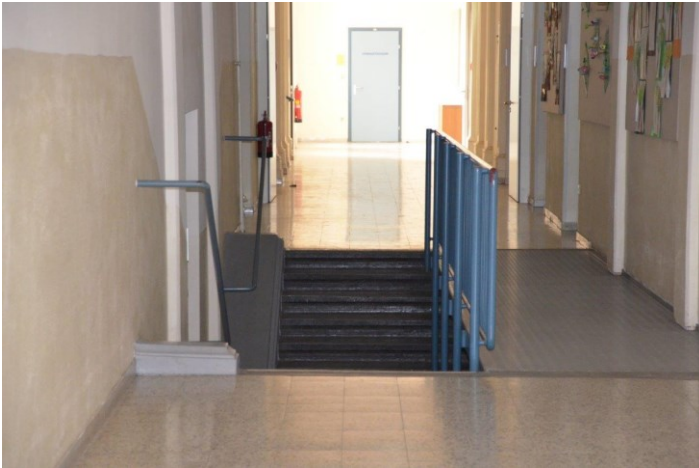
Abbildung 20: nicht barrierefreier Zugang zum Turnsaal Foto: StRH
