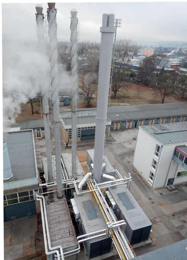
Heißwasserkessel in der Fernwärme-Zentrale Graz
