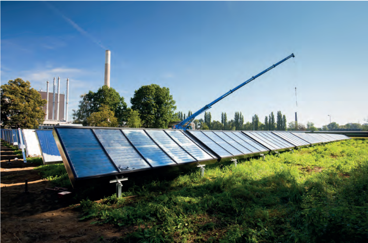
Solaranlage am Areal der Fernwärme-Zentrale Graz
