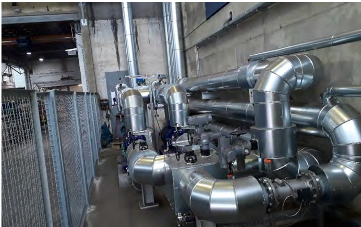
Restabwärmenutzung im Stahlwerk Marienhütte
