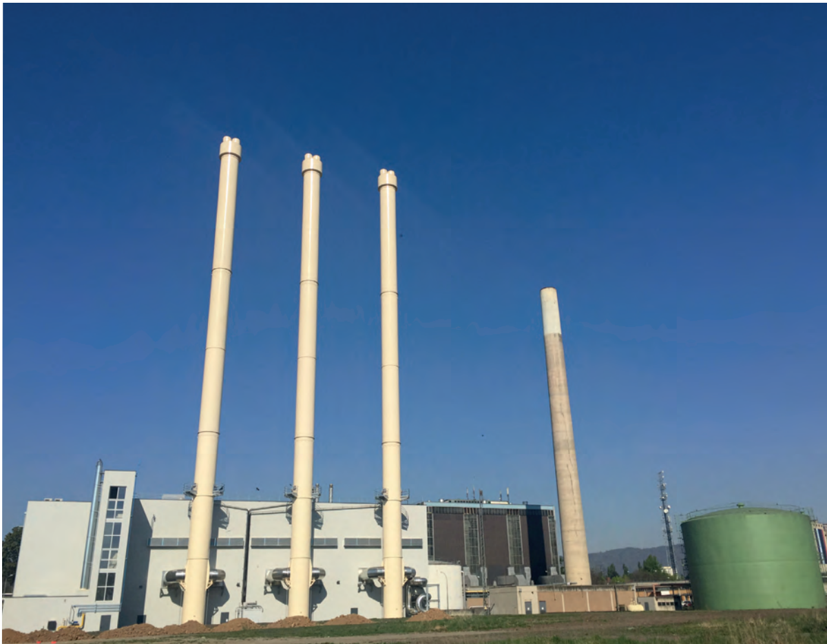
Erdgasbefeuerte Kesselanlage in der Fernwärme-Zentrale Graz
