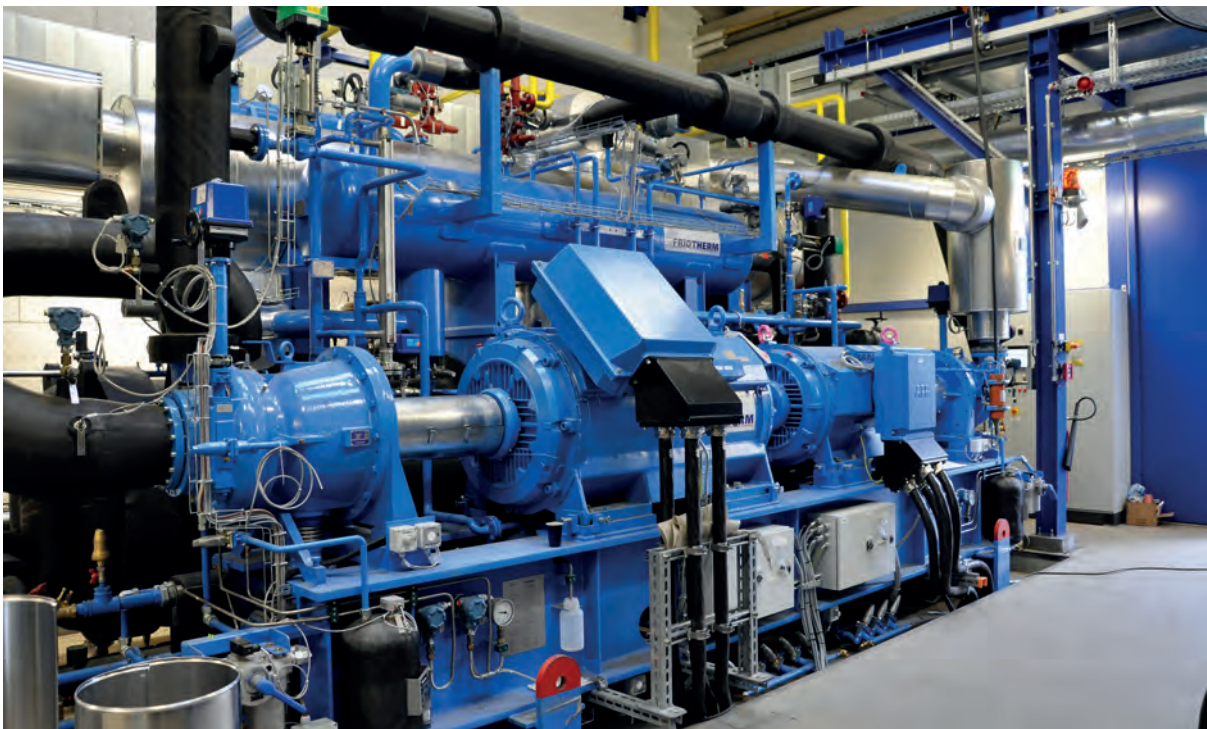
Wärmepumpe in der Marienhütte Graz
