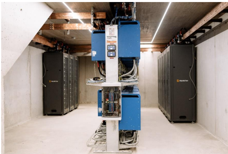
Blick in den Technikraum u.a. mit Wechselrichtern
