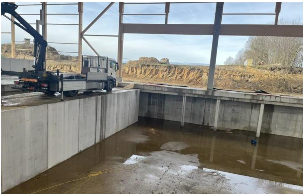
Copyright: Andreas Auer Landmaschinen Handel, Speicher vor Befüllung
